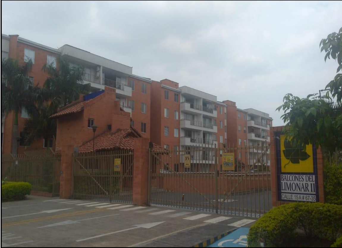
INTERVENTORIA EN OBRA CIVIL DE PINTURA E HIDROFUGADO EN FACHADAS Y ZONAS COMUNES DEL CONJUNTO RESIDENCIAL BALCONES DEL LIMONAR II.
