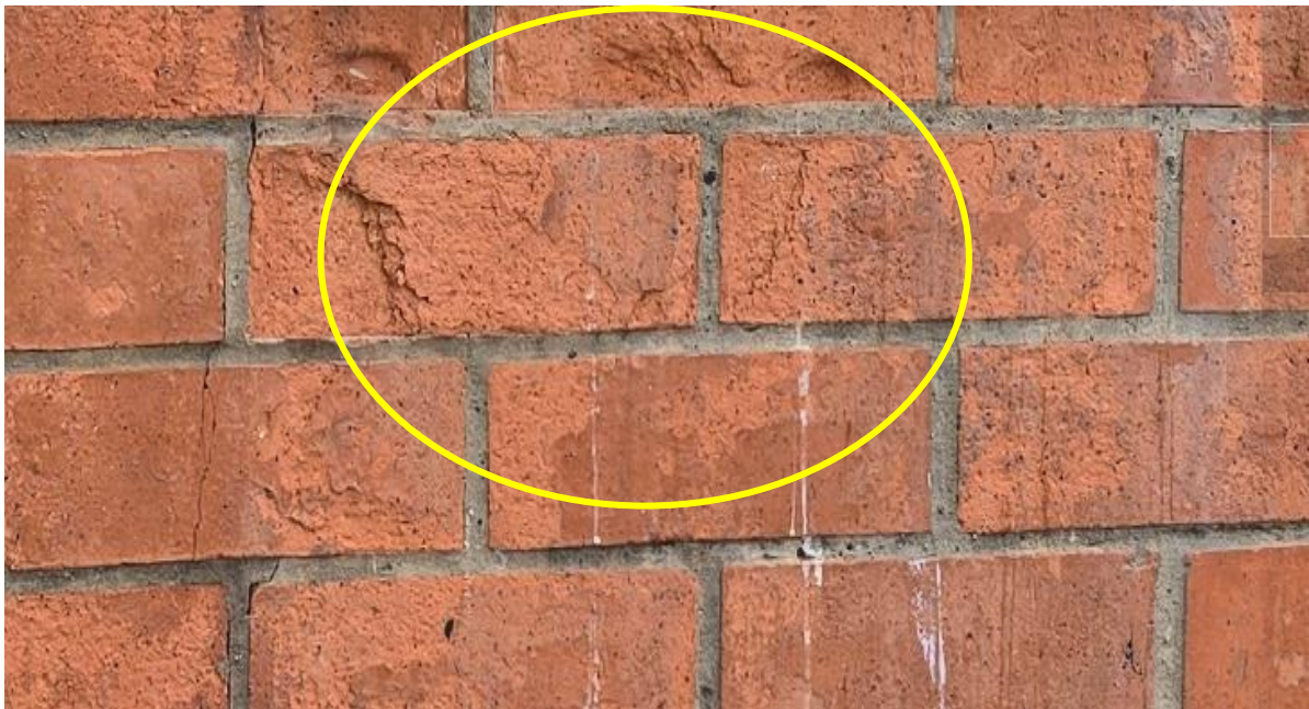
ENSEÑEMOS EROSION DE LA CARA DEL LADRILLO Y DESCONSOLIDACION DEL MORTERO DE PEGA.
