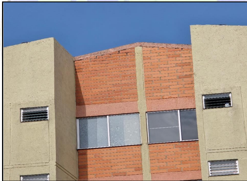
DETERIORO DE CORONAS POR AUSENCIA DE ALFAJÍAS.
