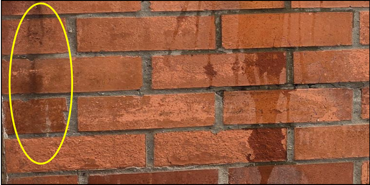
PRESENCIA DE HONGO E INICIO DE METEORIZACIÓN POR FALTA DE HIDROFUGO.
